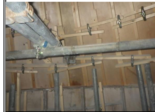
③ ガス冷却室 (4階)
