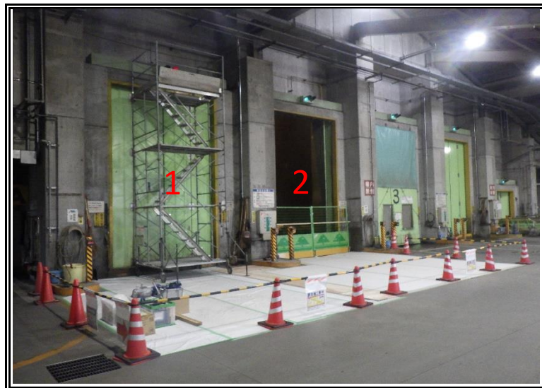
ごみ投入扉 1・2
