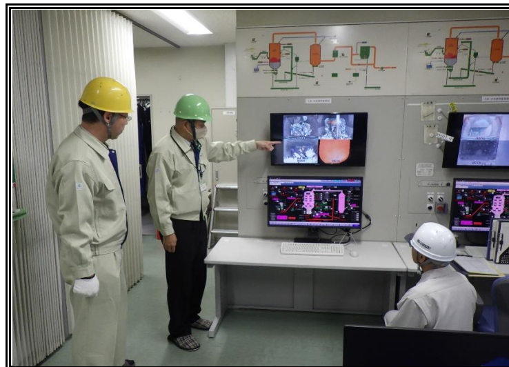
中央操作室操作機器検査
