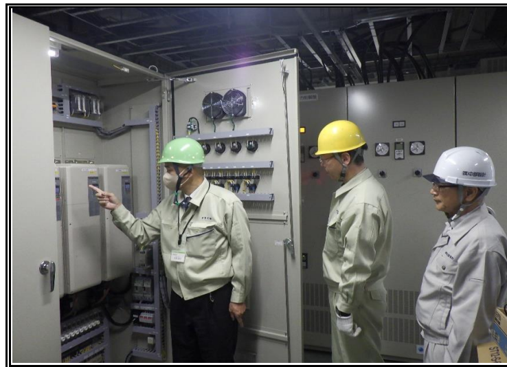
電気設備検査
